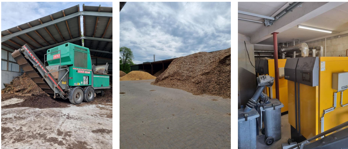
Abbildung 29: Biomassehackschnitzelanlage (links), -lager (mitte) und Holzhackschnitzelheizung (rechts) in Hoisbüttel (Eigene Aufnahme)
